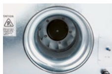
zvuková izolace na sání ventilátoru
