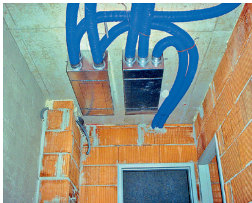
Detail zakázkových rozdělovačů EDF-M-BOX v suterénu budovy
