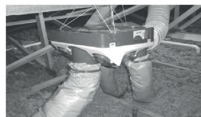
ventilátor je instalovaný
