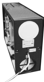
detail přívodních kabelů pro síťové připojení a připojení vypínače ohřevu
